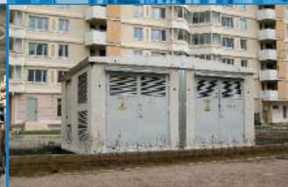
Блочная комплектная трансформаторная подстанция
